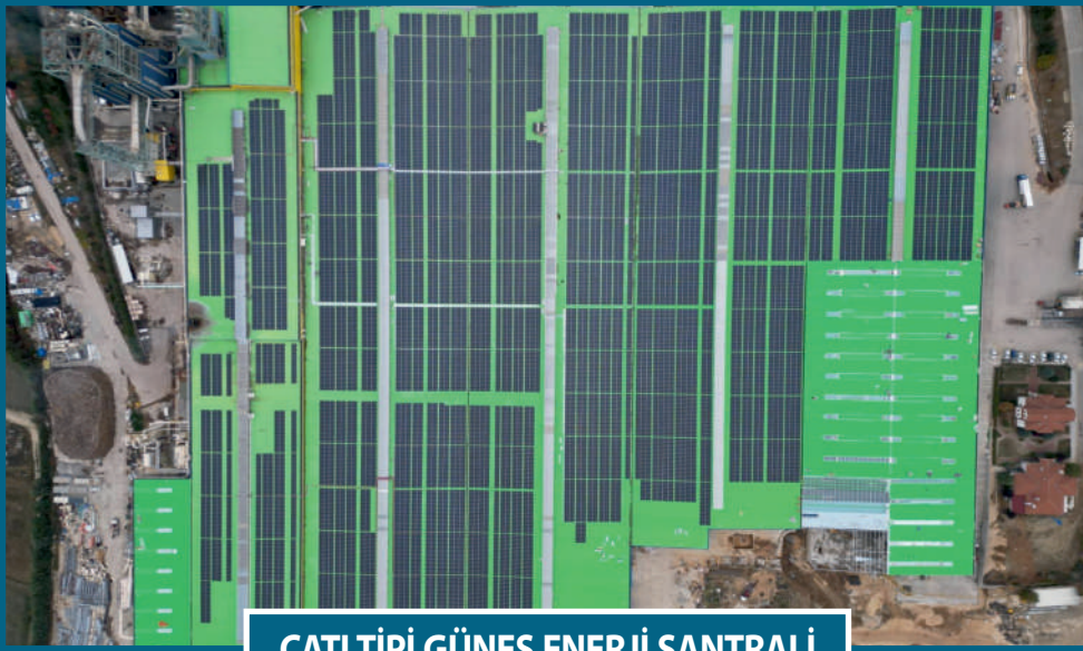
ÇATI TİPİ GÜNEŞ ENERJİ SANTRALİ
