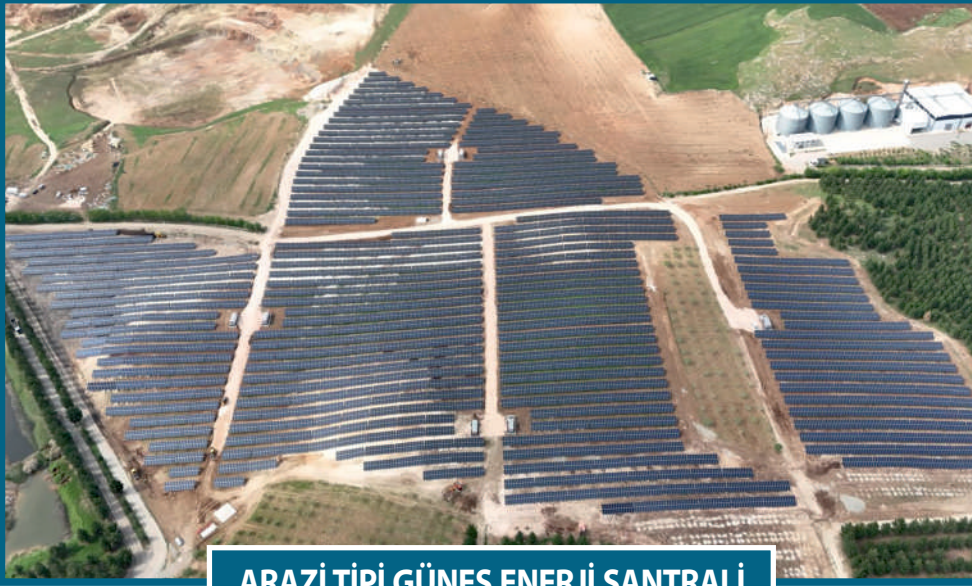
ARAZİ TİPİ GÜNEŞ ENERJİ SANTRALİ
